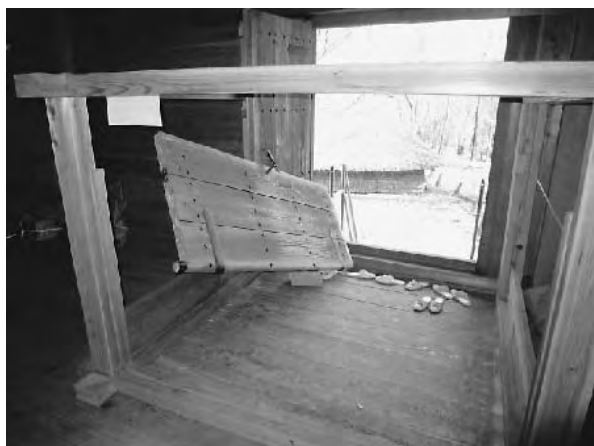
「奈良時代の倉庫」入口 被害状況
