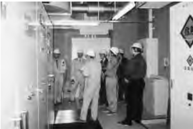
電気設備の検査
